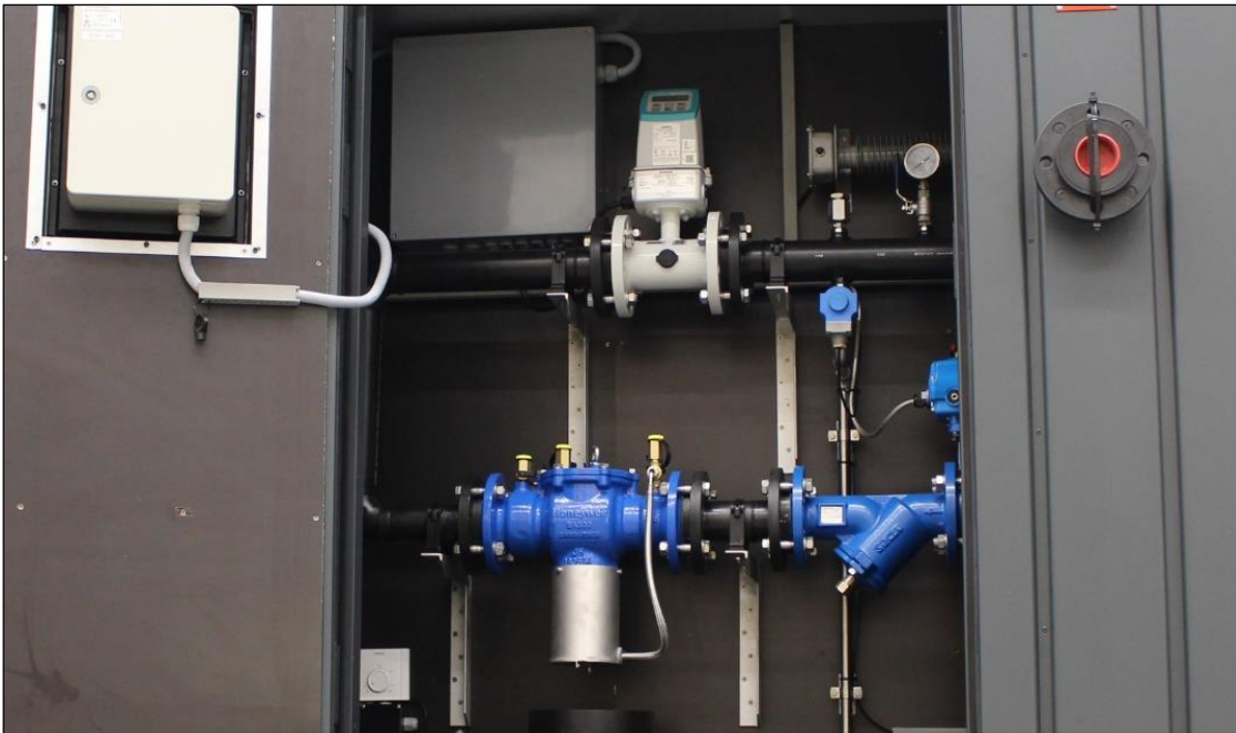
Figur 6.11. Eksempel på indretningen af en påfyldningsstation for store skibe med en kategori 4 sikring.
