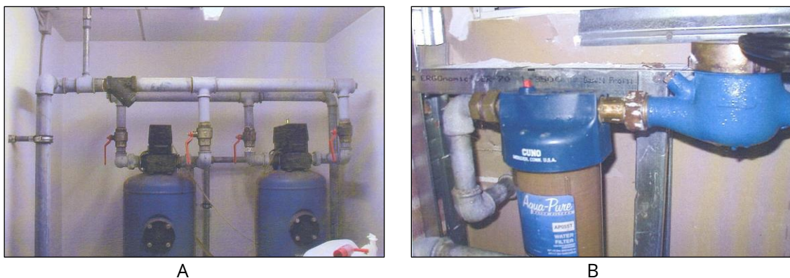
Figur 2.1. A: Forkert/ulovlig installation af blødgøringsanlæg i forbindelse med fællesvaskeri. Der er bl.a. fejl i forbindelse med monteringen af tilbagestrømningssikringen. B: Ulovligt filter anbragt uden tilbageløbssikringer før vandmåler i installation i børneinstitution.
