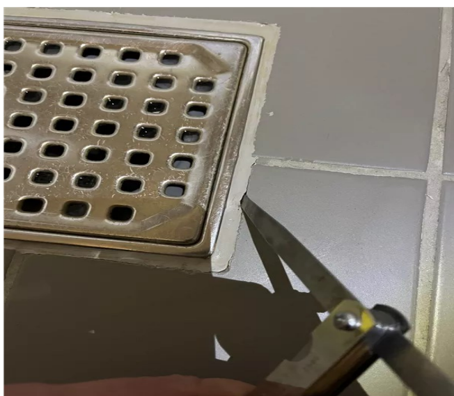
Driftseksempel: Fugeslip ved GULVAFLØB kan betyde, at vand kan trænge ned i gulvet.
