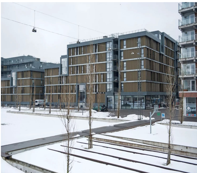
Kompliceret klimaskærm, problematisk vandafledning, sårbare konstruktioner. Sandsynlighed for krævende drift. Stort udbedringsprojekt gennemført efter få år.
