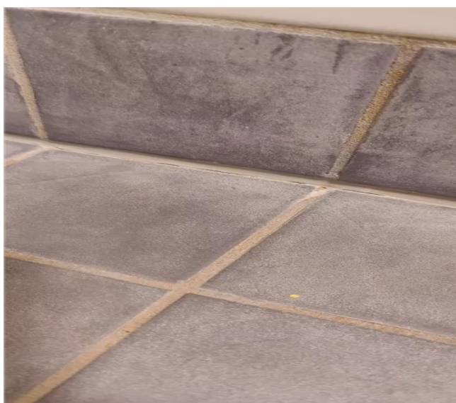
Driftseksempel: Fugeslip i SOKKELKLINKE skal udbedres for at sikre tæthed.
