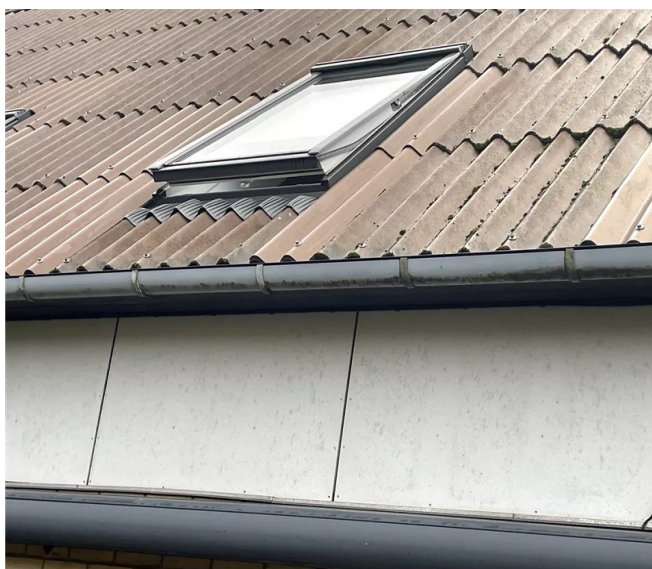
Driftseksempel: Løst TÆTNINGSBÅND i ovenlys kan medføre indtrængning af vand.
