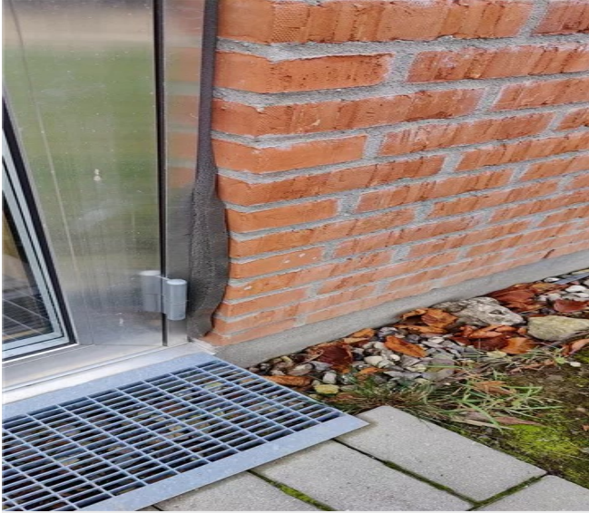
Driftseksempel: FUGEBÅND ved dør er faldet ud.
